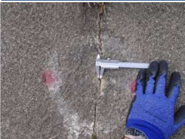
クラックの進行性や補修の必要有無を診断
