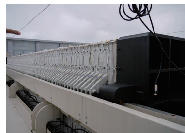
汚泥に圧力をかけ脱水
