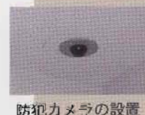
防犯カメラの設置
