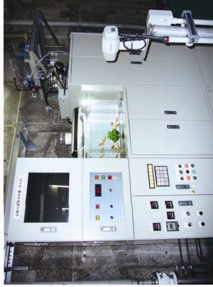
水質安全常時監視設備
