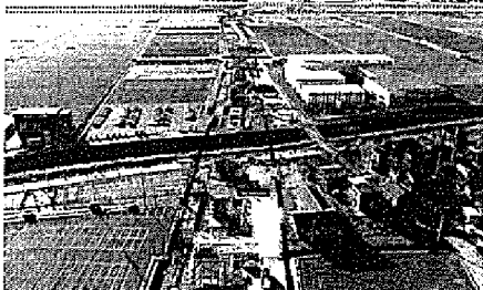
建設中の福井港丸岡インター連絡道路(坂井市丸岡町長崎付近) 令和4年11月撮影
