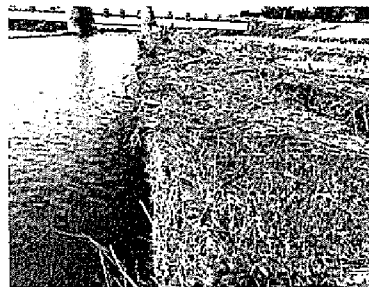
九頭竜川右岸取水口に堆積した塵芥
