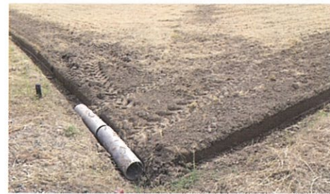
排水溝の崩れを防ぐ塩ビ管
