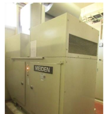
① 空港(株)非常用発電機 (H4)
