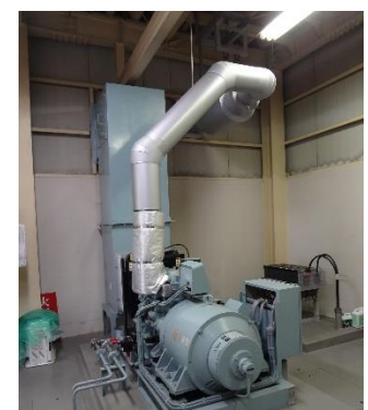
② 航空灯火用非常用発電機 (H17)
