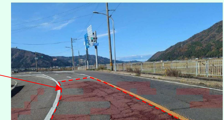
▲舗装損傷 AI検知イメージ
