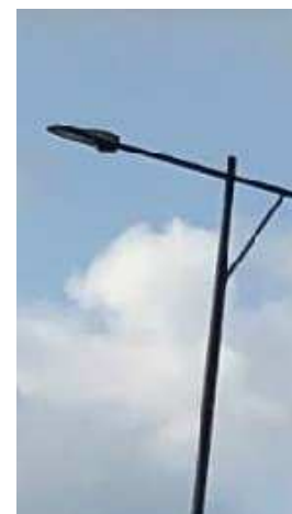
自然環境への影響が小さいLED照明の設置
