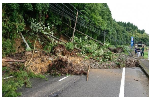
国道365号 法面崩壊(越前町下河原)
