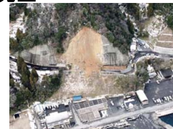
H14.3.7 おがわ 法面崩壊
