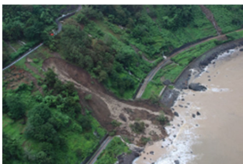
国道305号 法面崩壊(福井市居倉町)
