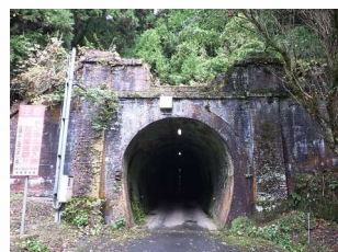
トンネルの老朽化
