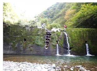
砂防堰堤の老朽化
