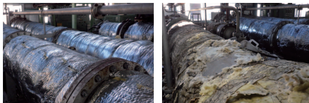
正常状態、ただしフランジ部は未対策 保温材の損傷箇所への補修が必要
