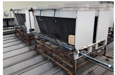
別冊「スーパーマーケット」の省エネ診断事業所では、冷凍機の室外機に散水設備がされていました
