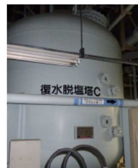
復水脱塩装置
