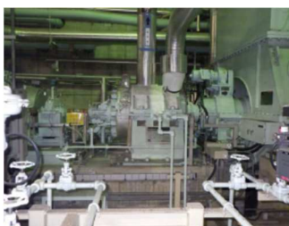
主給水ポンプ
