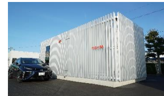
敦賀市に開設した再エネ水素ステーション (再生可能エネルギーで発電した電力により水素を製造)
