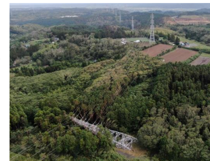
鉄塔設備の倒壊 (君津市)
