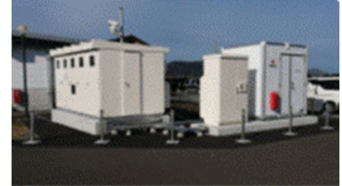
〔蓄電池（原子力事業本部）〕
