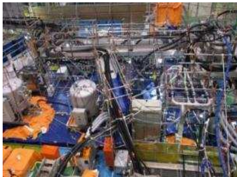
《除染装置設置状況》
