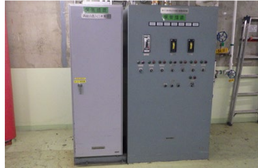
[再結合器入口水素計、排ガス復水器出口水素計・酸素計操作盤]
