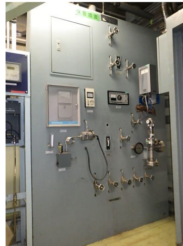
[復水器出口溶存酸素濃度計ラック、復水水質測定計装ラック]
