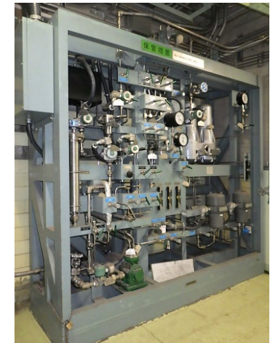
[排ガス復水器出口水素計・酸素計ラック]
