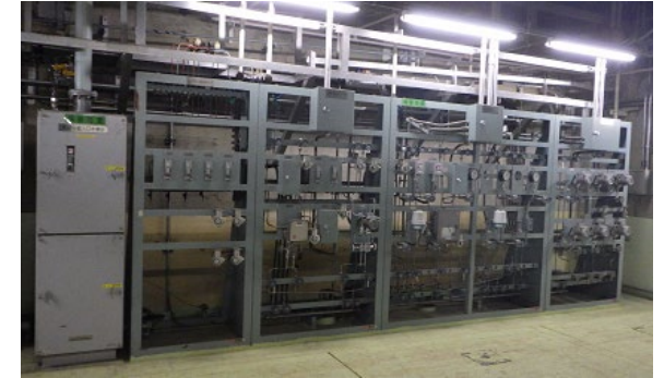
[再結合器入口水素計計装ラック、ヒータドレン系計装ラック、復水系計装ラック(Ⅰ)、復水系計装ラック(Ⅱ)、蒸気系計装ラック]
