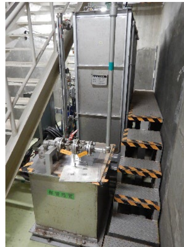
[亜鉛注入装置]
