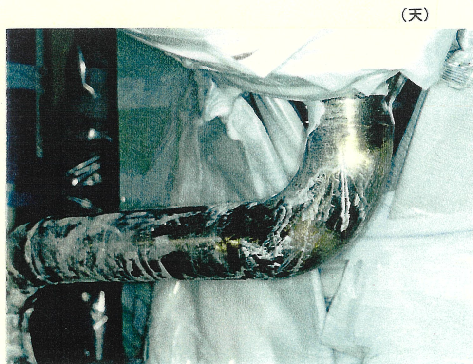
損傷部正面の全景
