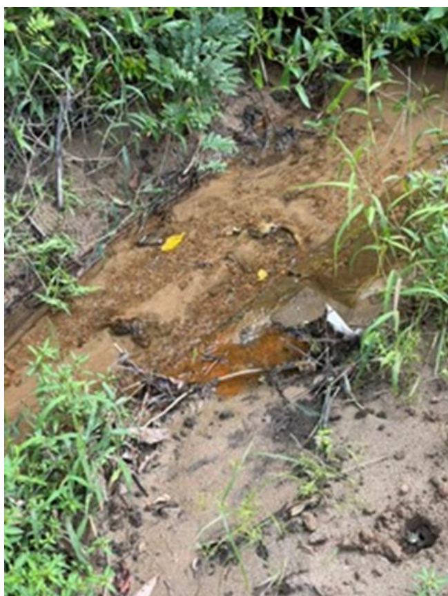
側溝に土砂が流入
