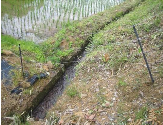
図 2 5 地形の変化点に支柱がなく、 電気柵と地面との隙間がある
