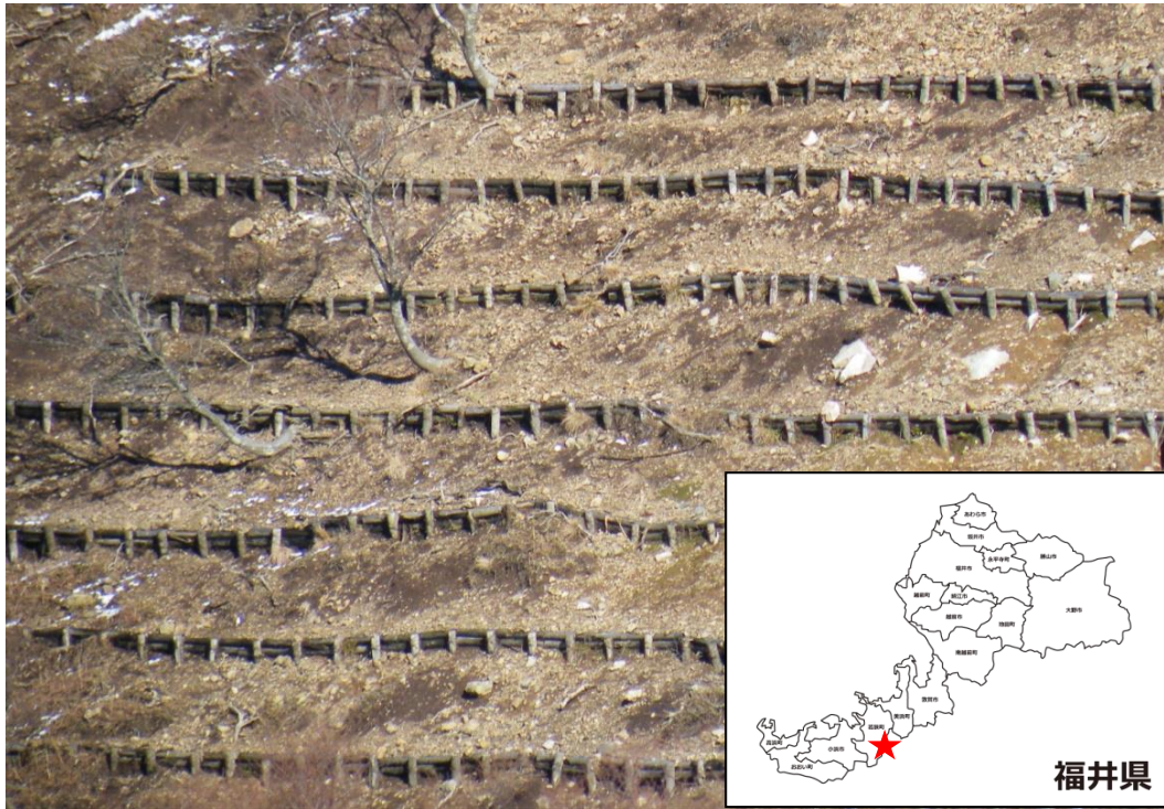
図 2 7 裸地化の進んだ土壌を土留めで抑えている状況（若狭町白屋 轆轤山）
