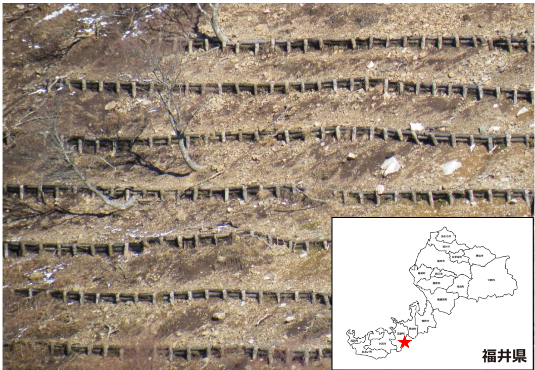
図 2 7 裸地化の進んだ土壌を土留めで抑えている状況（若狭町白屋 轆轤山）
