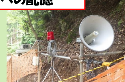
土石流センサーの設置
